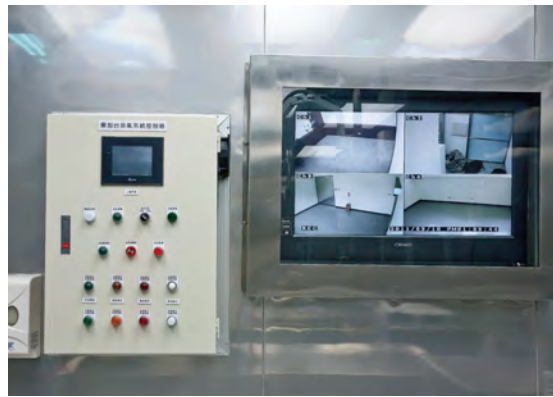
負壓空調控制箱、連接偵查庭之視訊設備
