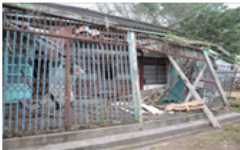
■緣側外平台毀損嚴重
